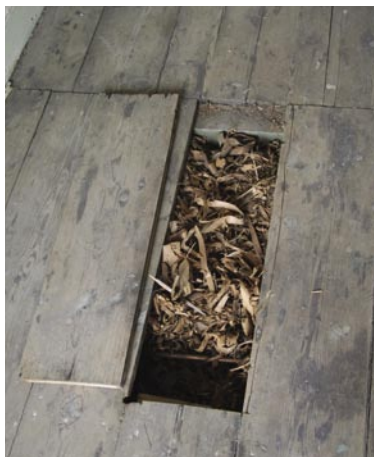
De houtkrullen tussen vloer en plafond. De hamer was al weg.
