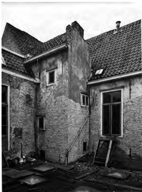
Boven: De traptoren, nog voor de helft afgedekt door de drukkerijhal die nog niet is weggebroken.
