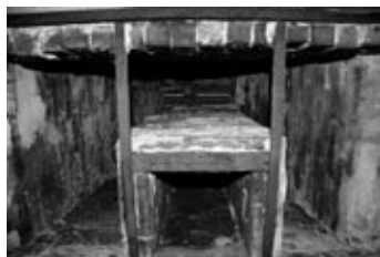
Het inwendig verkleinde rookkanaal.
