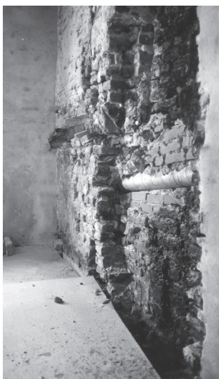
Niet alle muren waren even solide!
