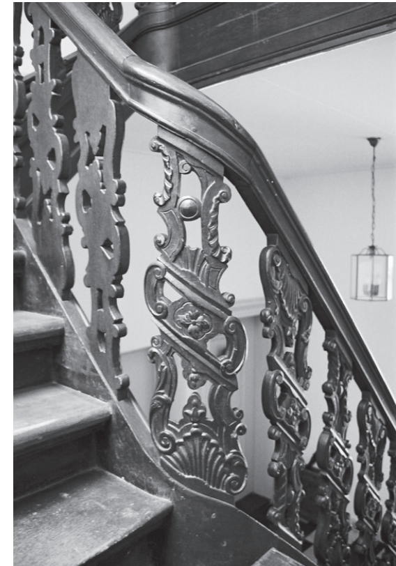
Afb. 23. Detail van de trap met de eenzijdig gesneden balusters (links) en de tweezijdig gesneden exemplaren (rechts).
