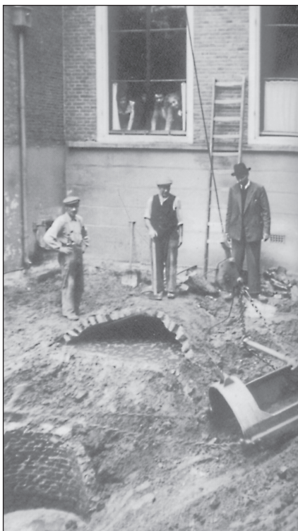
Een verrassing bij de verbouwing op het binnenterrein van Kromme Nieuwegracht 6, in 1952.
